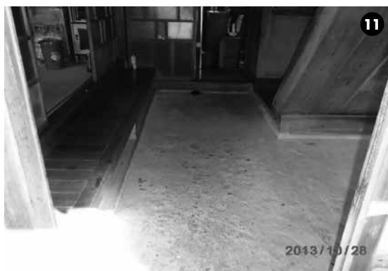
⑪土間から上がり框の段差は約40cm。ひとり暮らしのご高齢者には厳しい環境。
